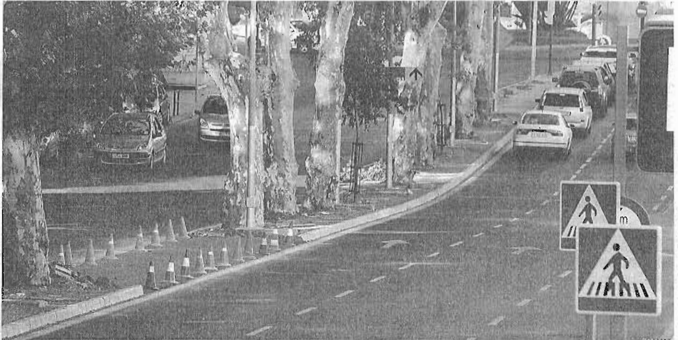
La obra para habilitar un tercer carril en el paseo de los Curas ya dejó hechas las canalizaciones para los semáforos en los futuros pasos de peatones. :: ÁLVARO CABRERA
