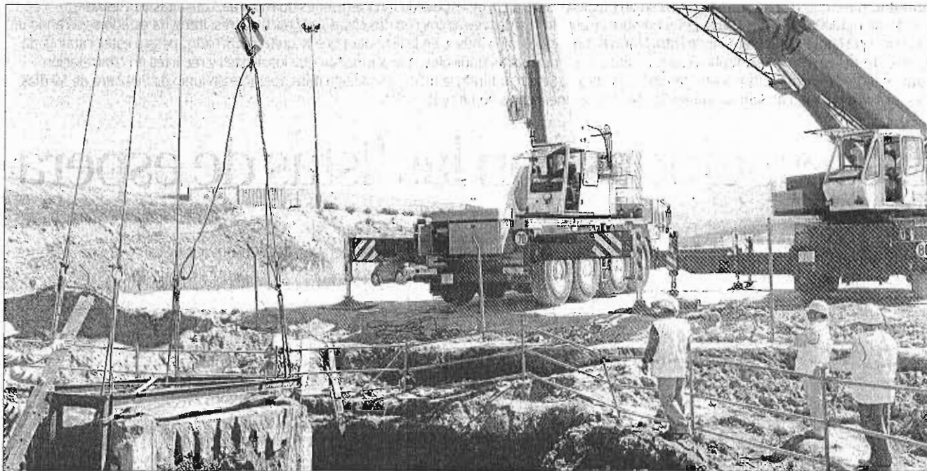
Obras de la Alta Velocidad de Málaga a Granada, de las pocas que siguen activas en Málaga. MARÍA ROSALES
