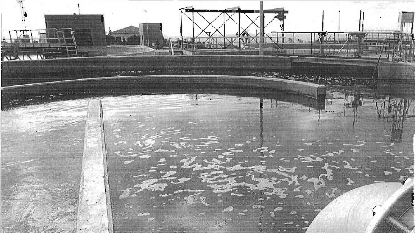
Detalle de la estación depuradora de aguas residuales de Rincón de la Victoria. GREGORIO TORRES
