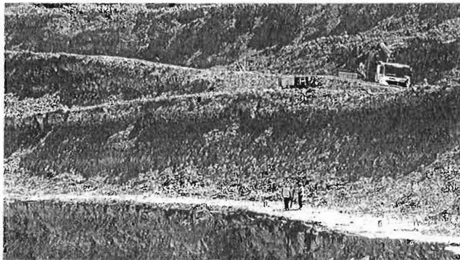
Operarios trabajando en Cobre las Cruces, donde Torsa ha implantado su sistema.
