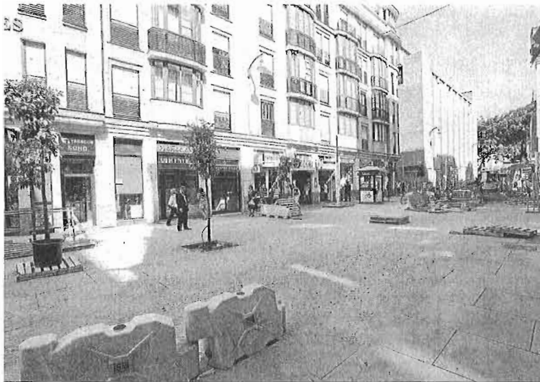
Obras de adecuación de la calle Tomás Heredia, en la zona del Soho.
