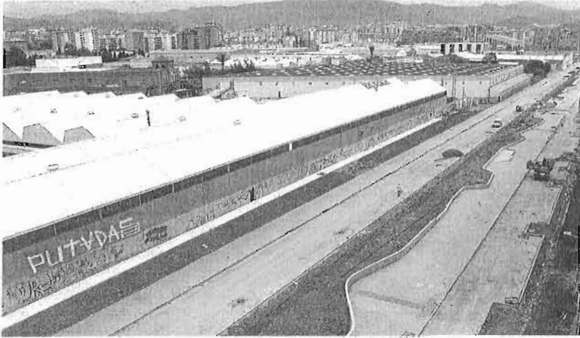
Las obras de la primera fase del bulevar avanzan a buen ritmo sobre el túnel del AVE. :: ALVARO CABRERA
