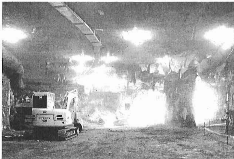
Excavación entre pantallas bajo Callejones del Perchel durante el pasado mes de julio. :: sur
