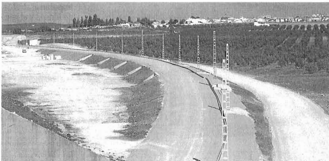
Tramo de la plataforma ya construida entre Antequera y Marchena del Corredor Ferroviario Transversal, paralizado desde 2011. :: sur
