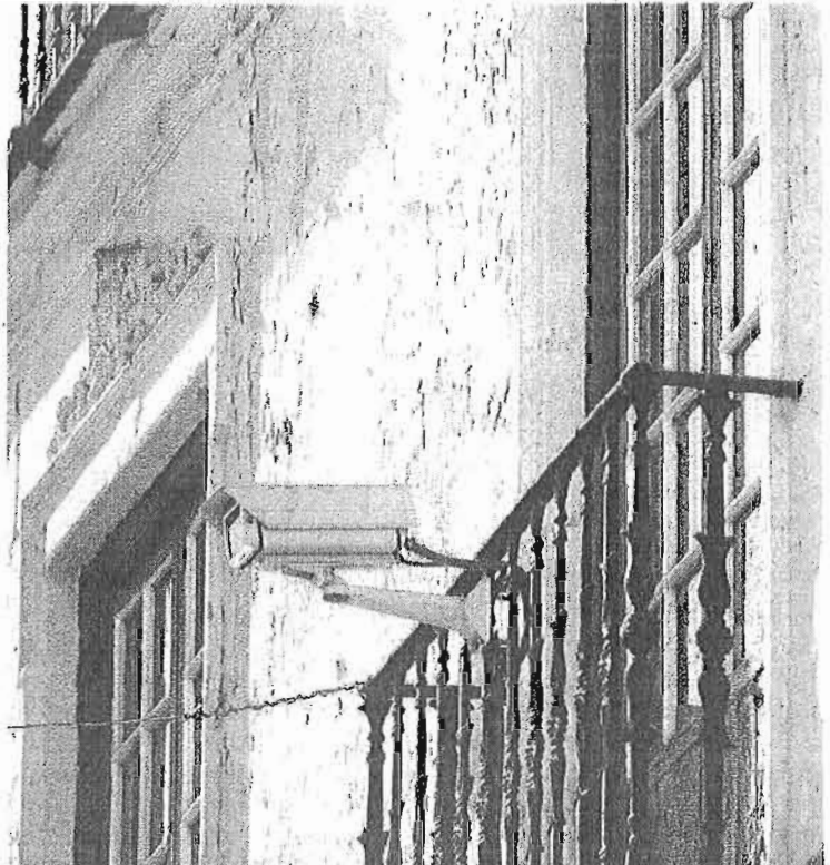
Una de las cámaras del sistema de videovigilancia instalado en el centro.
