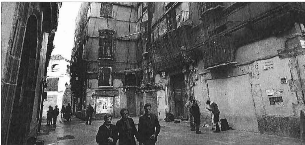
Sólo se conserva la fachada del antiguo edificio barroco, ya que hubo un derrumbe en 2006 de parte de la estructura. GREGORIO TORRES
