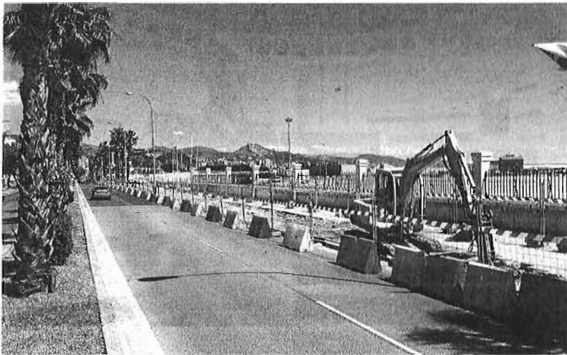
Las obras del nuevo acceso al puerto han obligado a ocupar parte de la calzada. :: FERNANDO GONZÁLEZ
