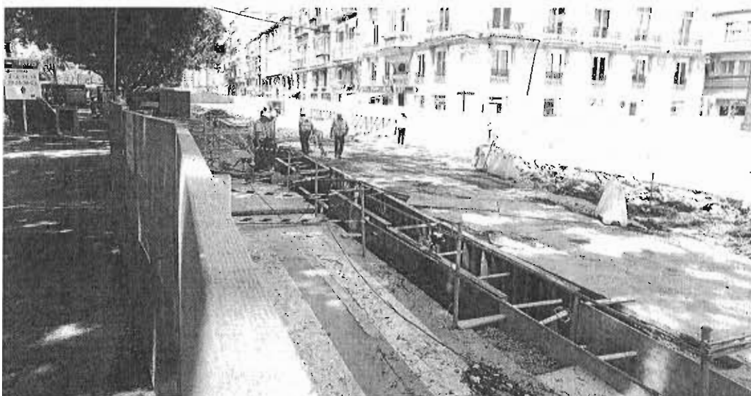
Trabajos para acometer los muretes guía para las pantallas del túnel del metro en la Alameda Principal. :: FERNANDO GONZÁLEZ
