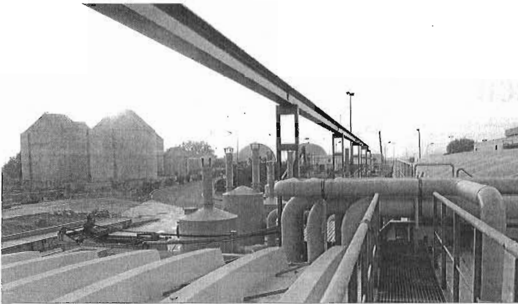
Instalaciones de la depuradora del Guadalhorce.
