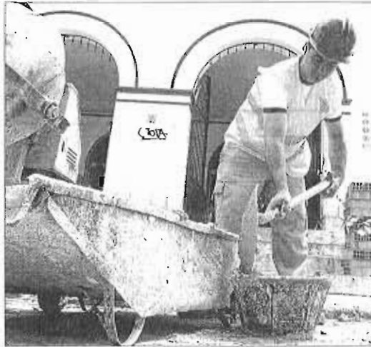
Una obra en un distrito de Málaga, en una imagen de archivo. ARCA/INEGA
