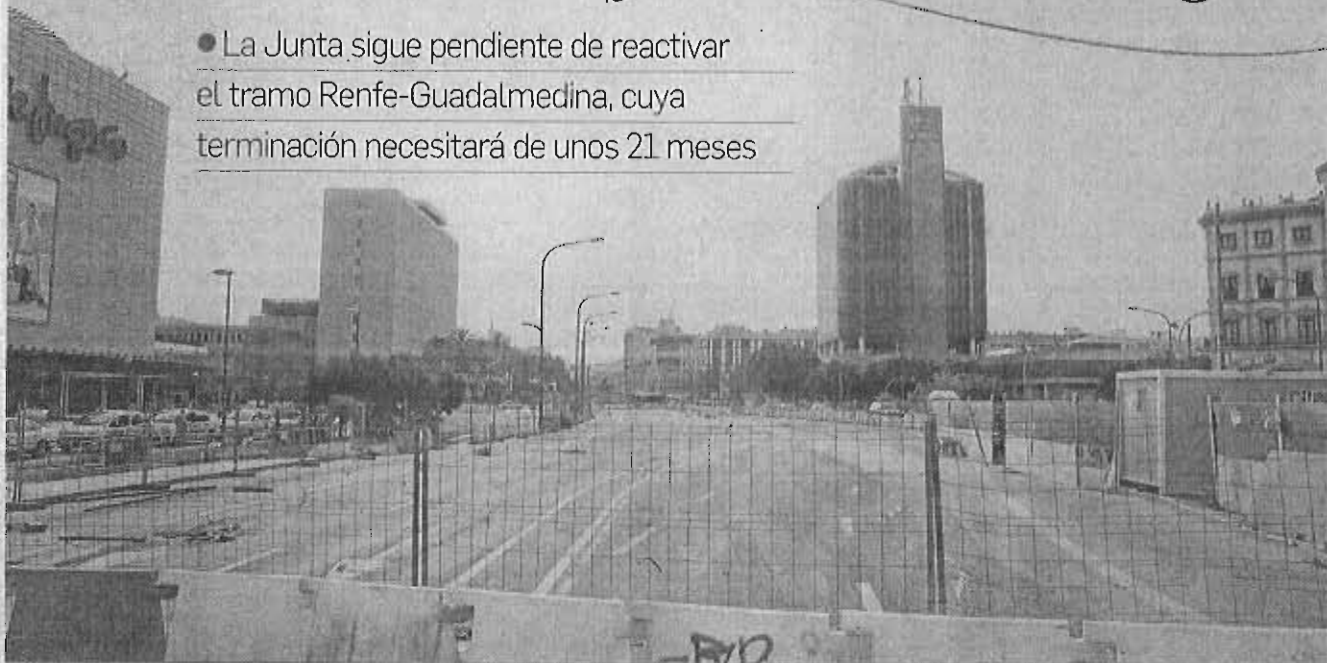
Estado de abandono en el que se encuentra el recinto de obra del tajo a la altura de El Corte Inglés.
