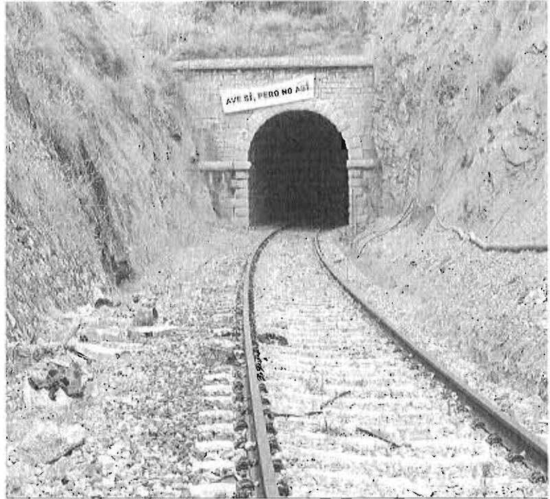
Uno de los túneles pendientes de adaptar para la línea del AVE Antequera-Granada a su paso por Loja.
