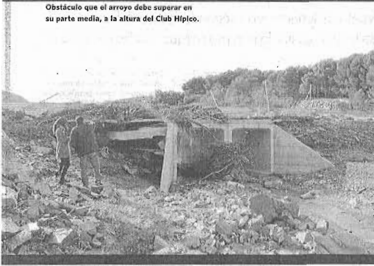
El arroyo Toquero ha sido gravemente alterado en su parte media por la urbanización Colinas de El Limonar.
